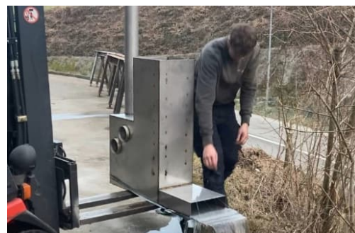
Bild 29: Erfolgreiche Dichtigkeitsprüfung des Ofens indem wir die Ascheklappe mit Silikon versiegelten und dann den Ofen mit Wasser füllten indem wir die Ascheklappe mit Silikon versiegelten und dann den Ofen mit Wasser füllten. - Testfeuer.
