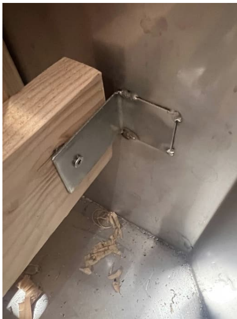
Bild 61: Verbinden der Holzelemente im Hot-Tub mit Winkeln, welche wir mit «Mikro-Tak» an Becken geheftet haben
